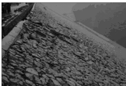
图 2 下游斜坡保护的震损情况
