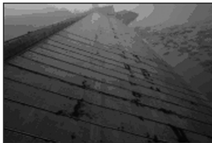
图 1 坝体面板震损情况
